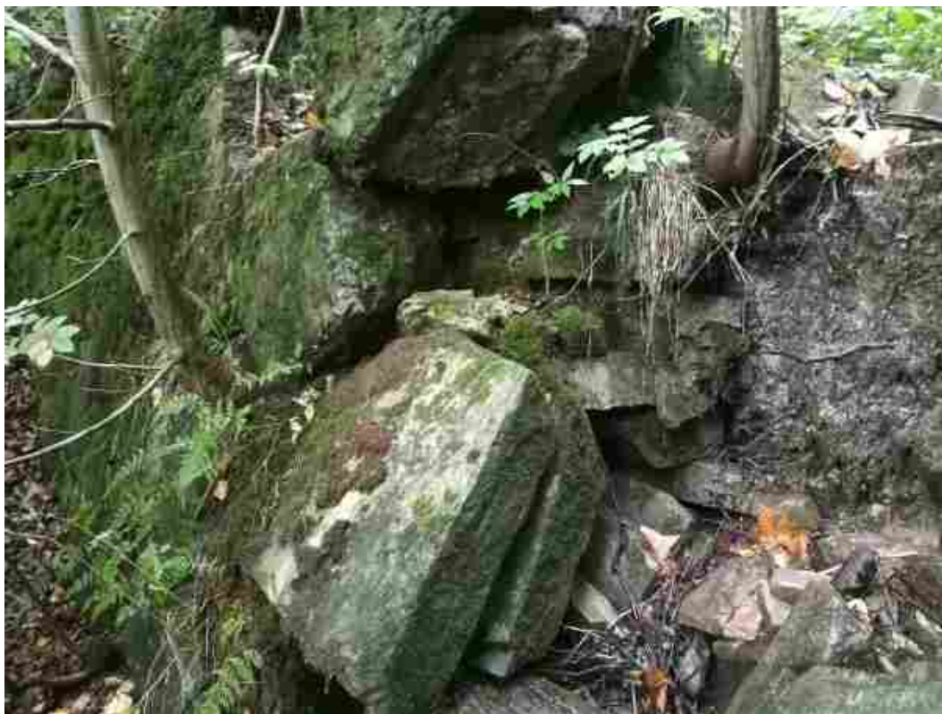
FOTOGRAFIA 7 USZKODZENIA KORPUSU ZAPORY.
