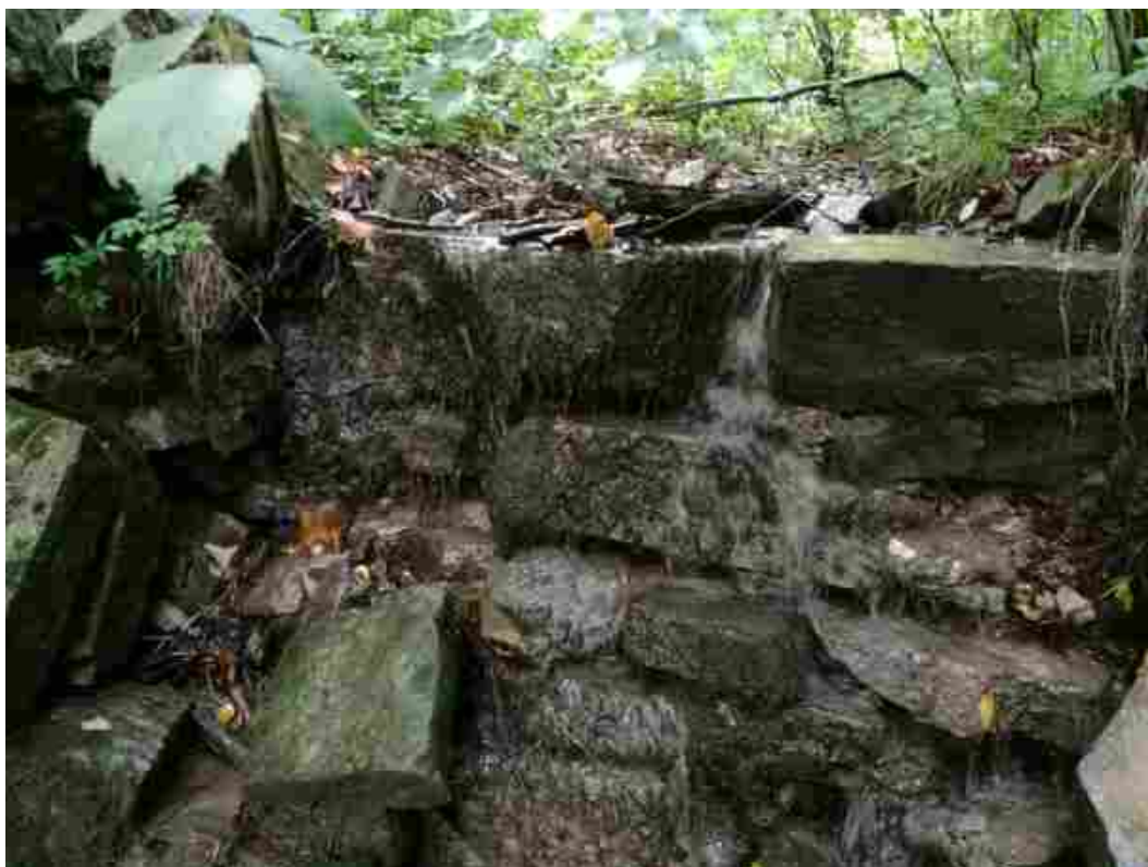
FOTOGRAFIA 8 USZKODZENIA KORPUSU ZAPORY.
